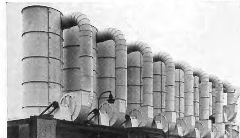
▼ FÜR DIE SCHLEIFEREI im I-Bau wurde von der MAN eine moderne Absaugungsanlage errichtet.
