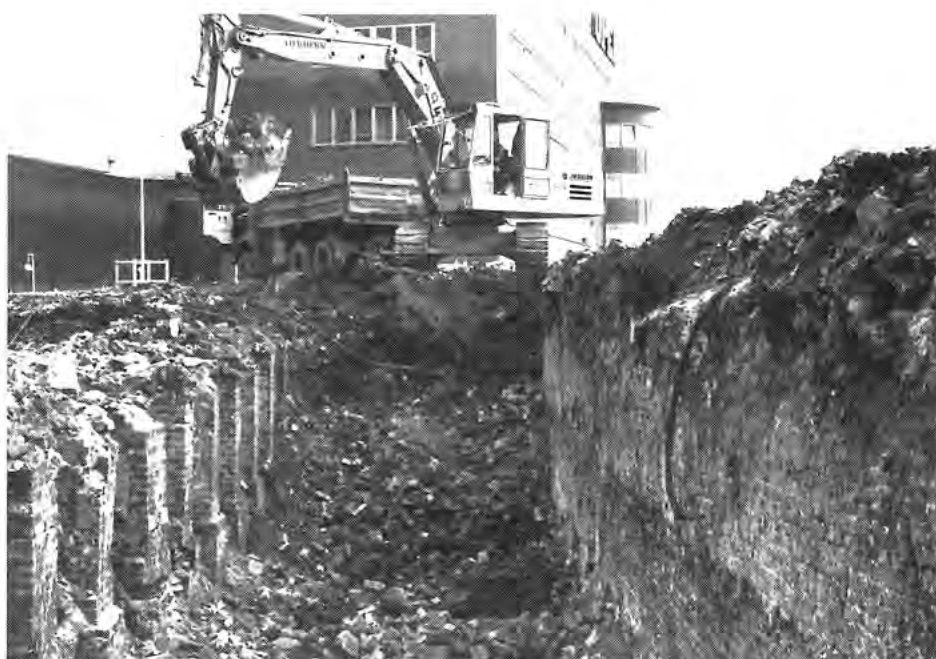
Der Bagger frißt sich in den historischen Grund. Im Hintergrund der Bau D 1.
