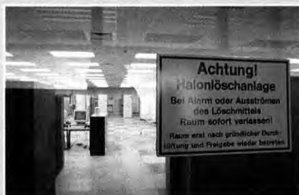
Hinweis: Im Brandfall löscht hier Halon
