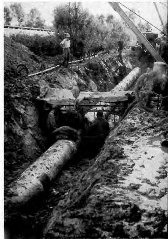
DAS VERSCHWEISSEN der Nahtstellen war eine wichtige Arbeit, von der die Dichtigkeit des Leitungssystems abhängt
