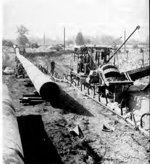
GRABENBAGGER SCHAUFELTEN sich 1,70 m tief ins Erdreich hinein und legten das Bett für die Rohre frei
