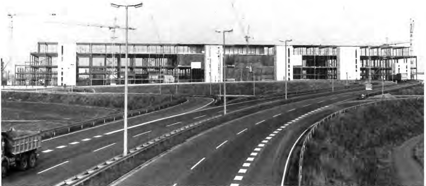
Langsam nimmt die neue Spritzlackiererei im Südwesten des Rüsselsheimer Werksgeländes Gestalt an. Auf dem Bildausschnitt lassen sich die Ausmaße dieses Produktionskomplexes nur erahnen.
